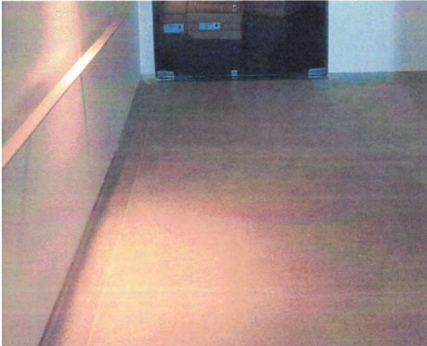
Figura 04. Piso monolítico de alta resistência mecânica (granitina com argamassa uretânica) executado no prédio do CAT 0720140001401-EMBRAPA.
