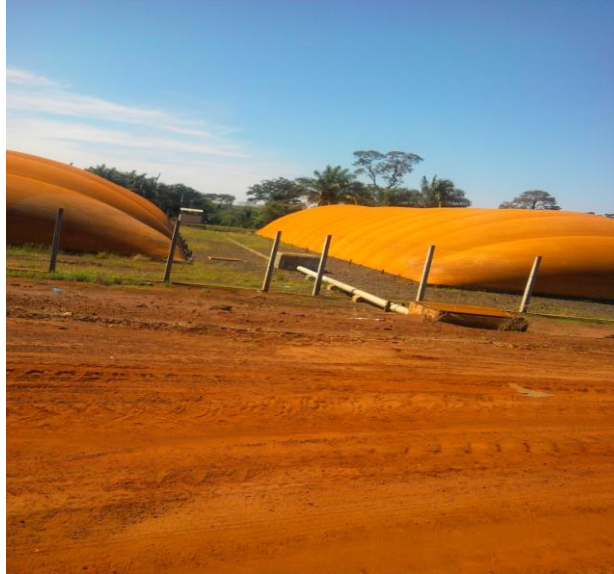
Figura 7 - Biodigestor modelo canadense.
