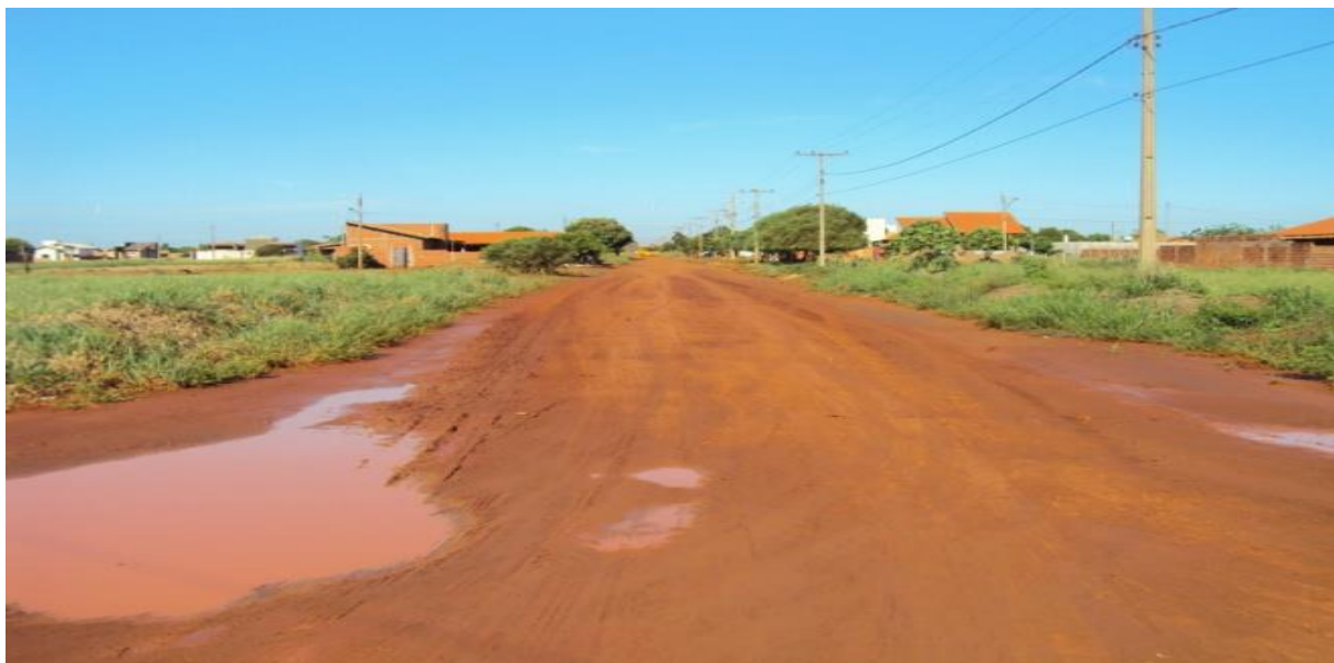
Figura 6 - Rua sem pavimentação asfáltica – Janeiro (2013)
